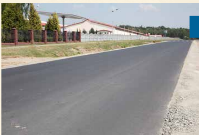
Przebudowa drogi powiatowej nr 1490 D w Goszczu - etap 2 dotacja Gminy Twardogóra: 62 301,20 zł Porozumienie z Powiatem Oleśnickim
