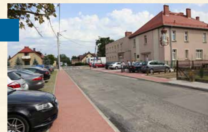
Remont chodników przy ul. Grunwaldzkiej i Wa- ryńskiego oraz utwardzenie placu przy budynku SZPZOZ i Przedszkolu Miejskim w Twardogórze wartość: 581 909,52 zł
