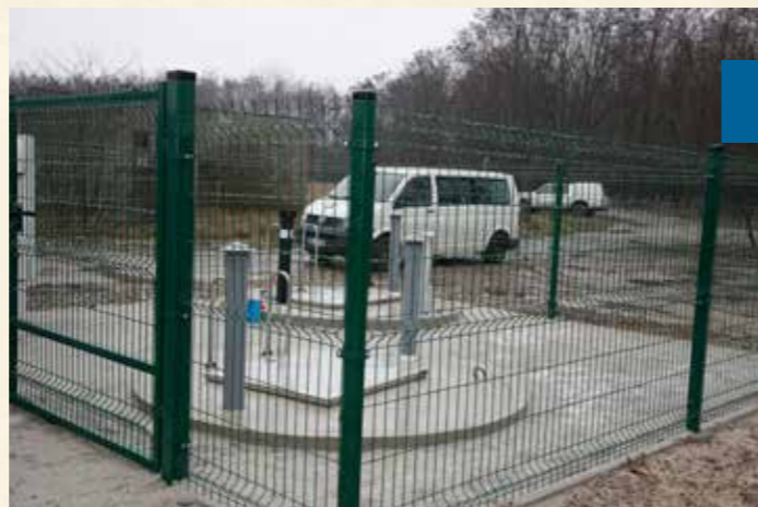
Budowa sieci kanalizacji sanitarnej w Goszczu i Grabownie Wielkim wartość: 13 373 393,07 zł dofinansowanie: 5 952 352,74 zł
