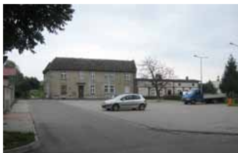
przebudowa nawierzchni drogi i parkingu pomiędzy ul. Kopernika i Ogrodowej przy OSP
