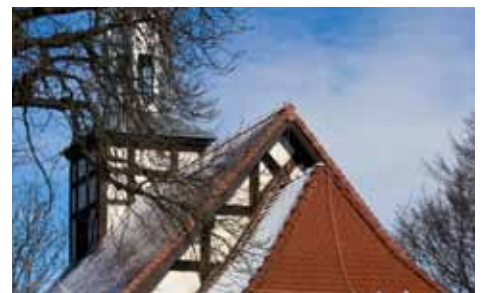
remont kościoła p.w. Św. Trójcy i Matki Boskiej wraz z zagospodarowaniem terenu
