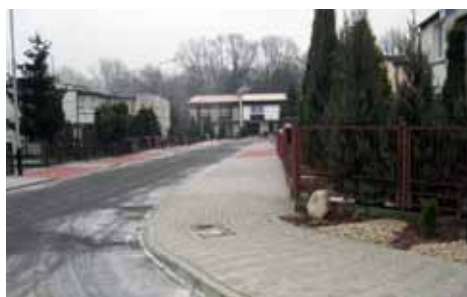
budowa chodników w ul. H. Wiernego, W. Łokietka, B. Chrobrego, W. Warnerczyka
