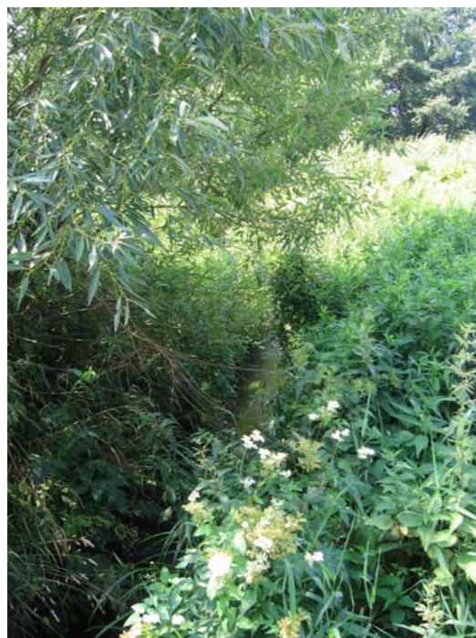
Fot. nr 29. Grabowno Małe – „Czarny Rów” w złym stanie technicznym.
